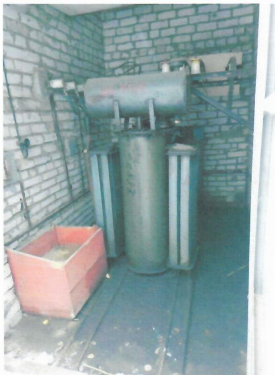
Рисунок 3 – Общий вид трансформатора ТМ-400 (серийный номер 23695) ТП-46
