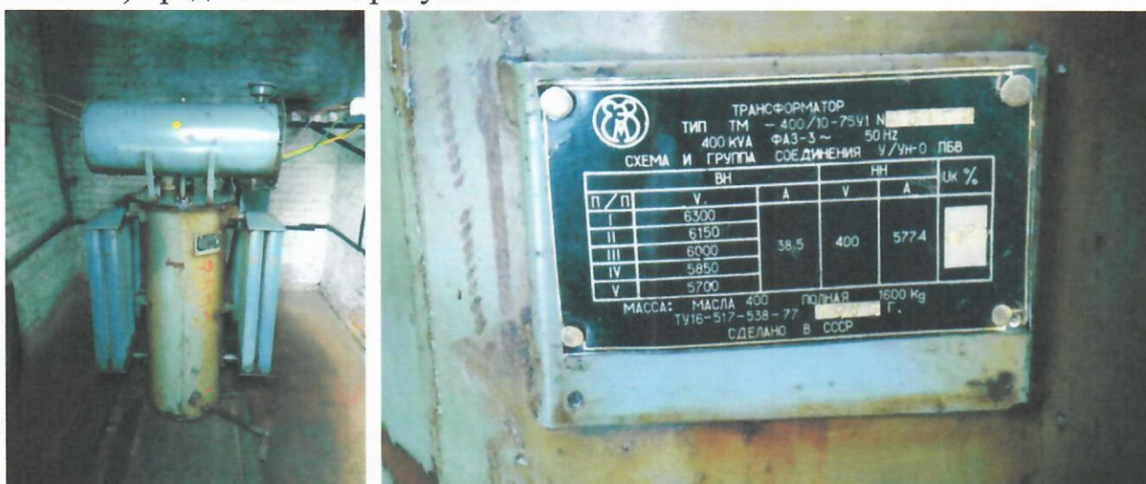
Рисунок 4 – Общий вид трансформатора ТМ-400 (серийный номер 1471729) ТП-372
